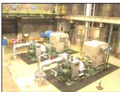
蒸気タービン発電機
